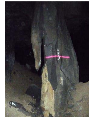
Beschädigter Basalt- Stützpfiler
